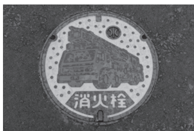
▲地下式消火栓
