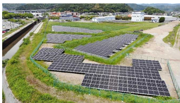
太陽光発電整備
